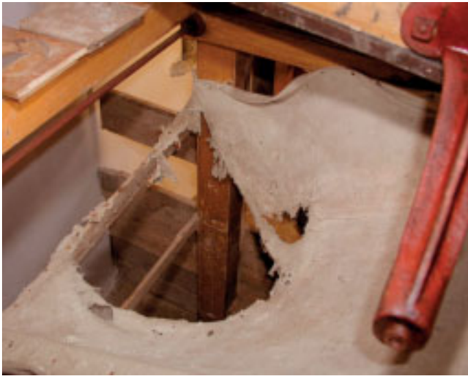
6 Das Auffangtuch an der Gerbmaschine vor der Restaurierung.
